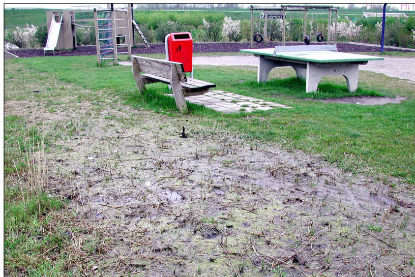
Lekkage veroorzaakt veel wateroverlast.
