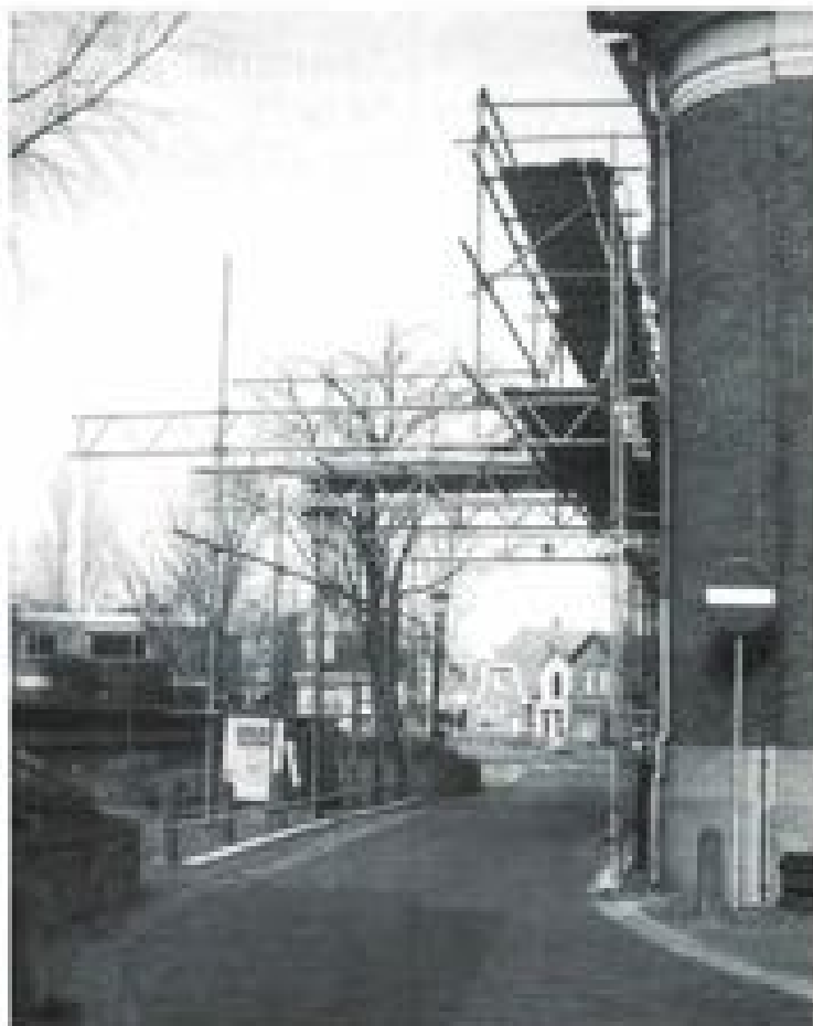
De werkzaamheden aan het Reght Huys vertonen in de tweede fase, vandaar de senger aan de westkant van het gebouw.
